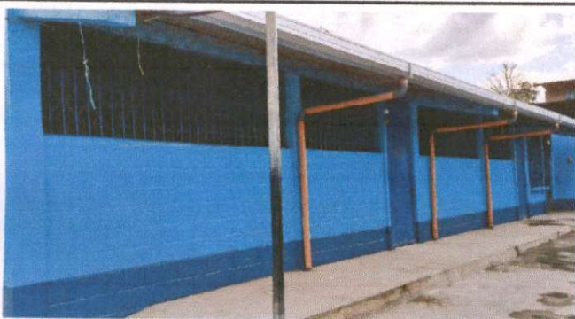
Foto 9: Pintura en paredes exteriores modulo de aulas.
